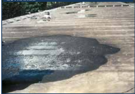
POZZANGHERA CON DEPOSITO DI SOSTANZE ESTRANEE
