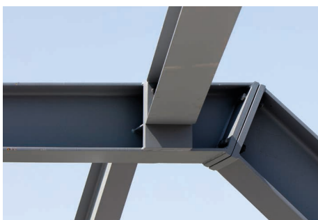
Corrosione e protezione al fuoco delle strutture, Pag. 24
