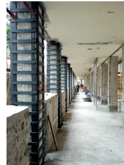
Prima di incollare gli angolari sono stati regolarizzati gli angoli dei pilastri in c.a. con la malta Sika MonoTop® X3 R
