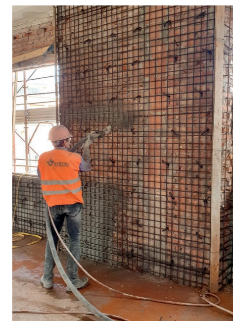
La medesima procedura è stata applicata dall'interno in modo da formare un rinforzo strutturale a sandwich
