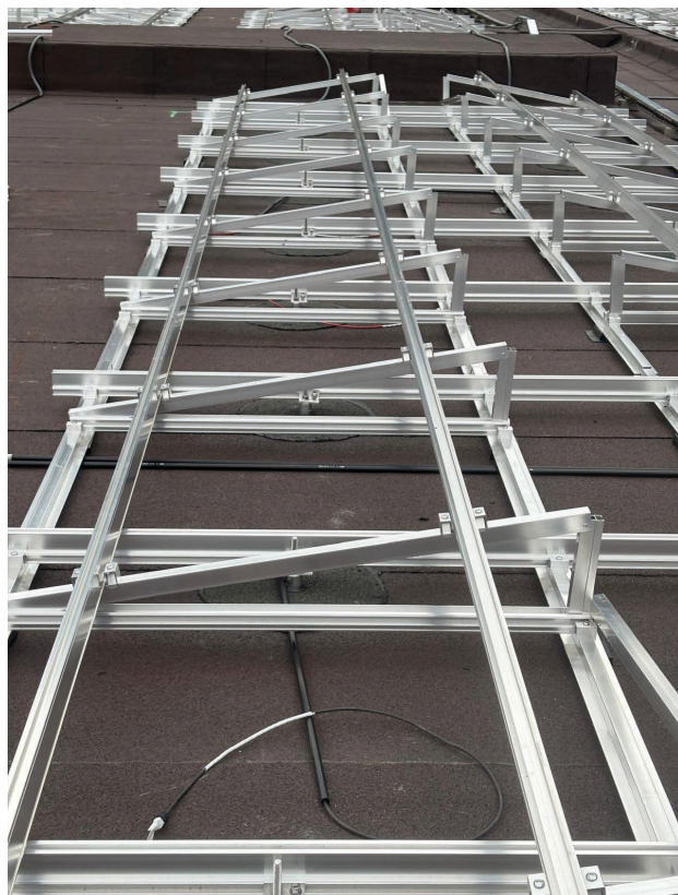
Struttura portante del sistema fotovoltaico.
