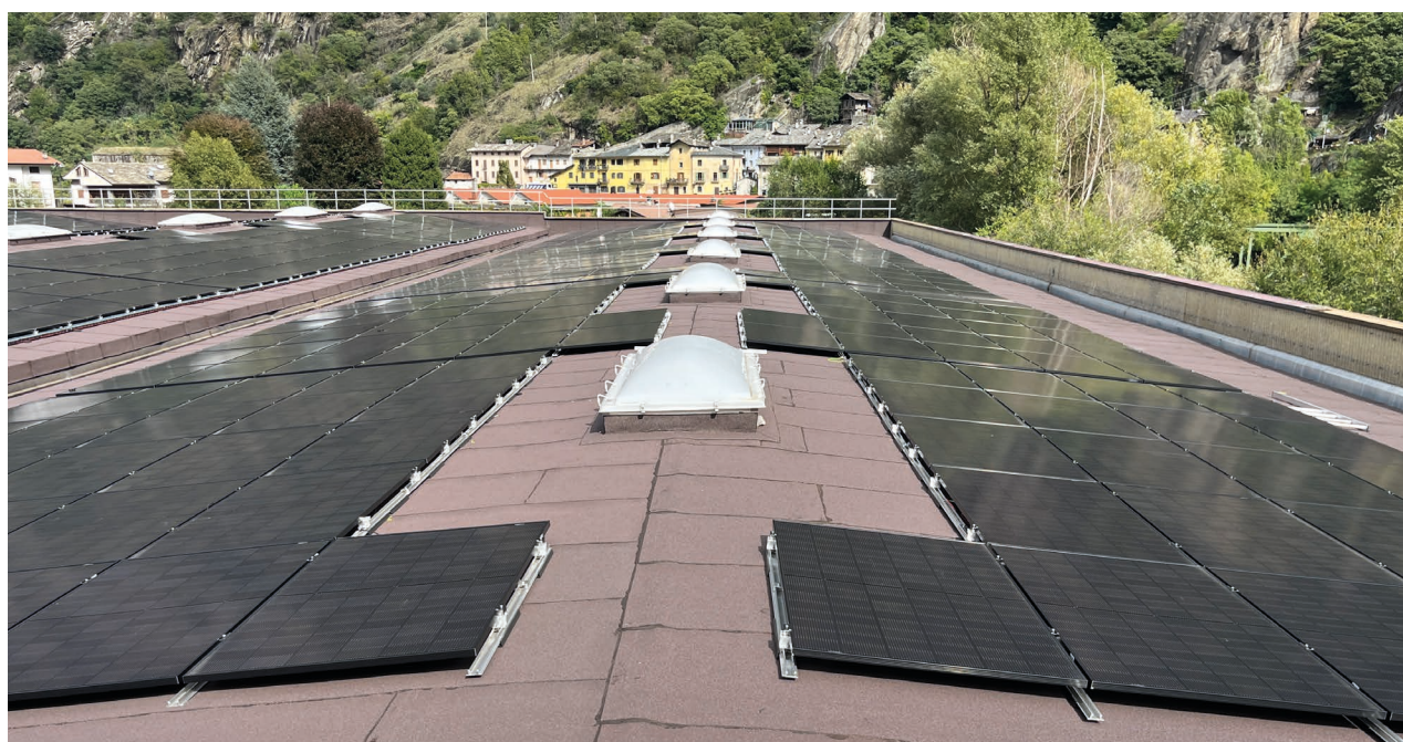
Sistema fotovoltaico installato.
